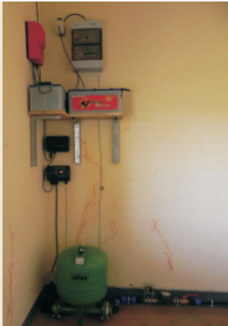
Strom- und Wasseranlage in der Schule
