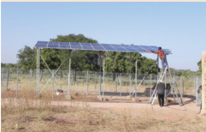
Die benötigte Energie liefert eine PV-Anlage
