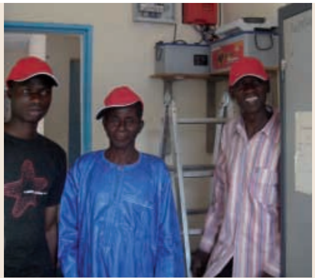
Technikraum in der Geburtenstation
