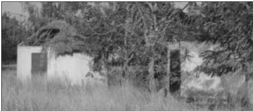
Vom Sturm zerstörte Dächer, die aus Mitteln des VEZ wieder repariert wurden
